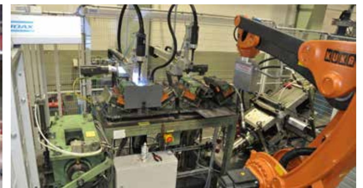
Roboter zum Transport von Blechteilen in eine Schweißanlage
